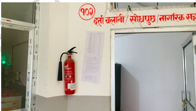
कार्यालय भवन भित्र राखिएका Fire Extinguisher
