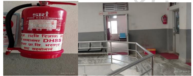
कार्यालय भवन भित्र राखिएका Fire Extinguisher
